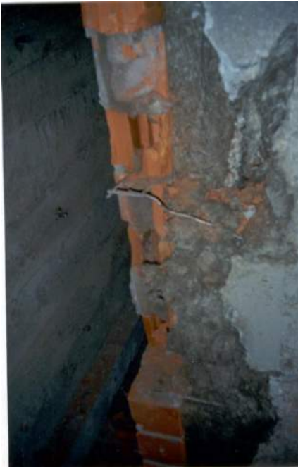
Рисунок 2.15 – Повреждения при одностороннем нагружении 4-х слойного фрагмента (наружная кирпичная верста)
